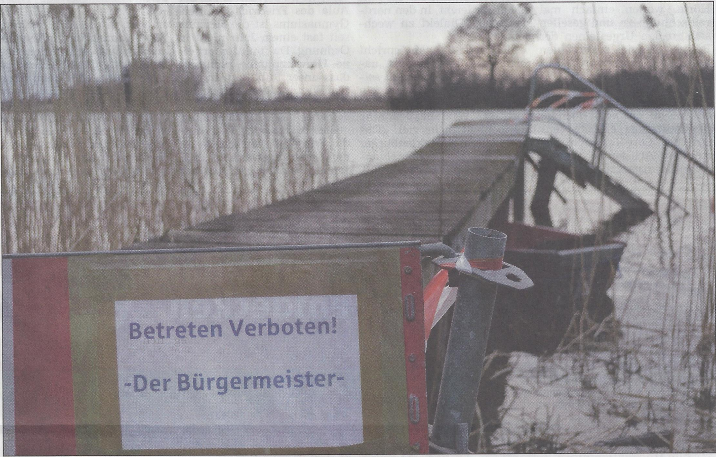
Wegen Winterschäden vorerst gesperrt: der Steg am Passader See in Stoltenberg.
