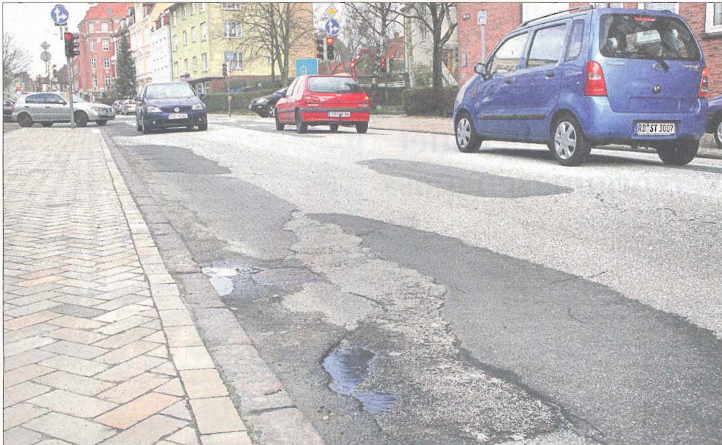
Straßenschäden und Schlaglöcher: Wegen des enormen Busverkehrs zwischen Brunswiker Straße und Beselerallee muss die Feldstraße saniert werden. Foto Jürgensen
